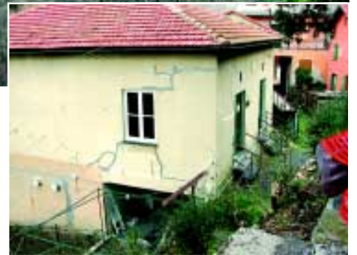
Figura 4 - Esempio di lesioni su un'abitazione in loc. Boasi
